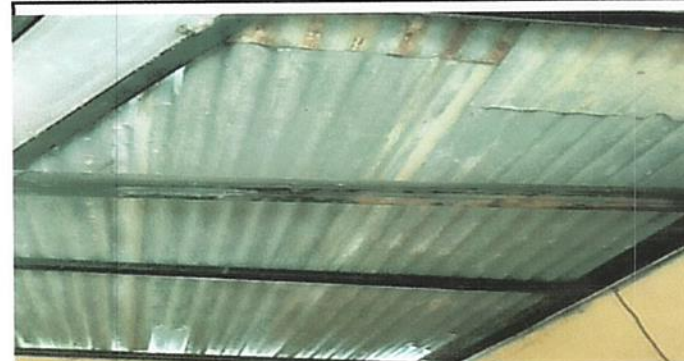
Foto 10: Las láminas se doblaron, se han ajustado con otros pedazos, para evitar la humedad.
