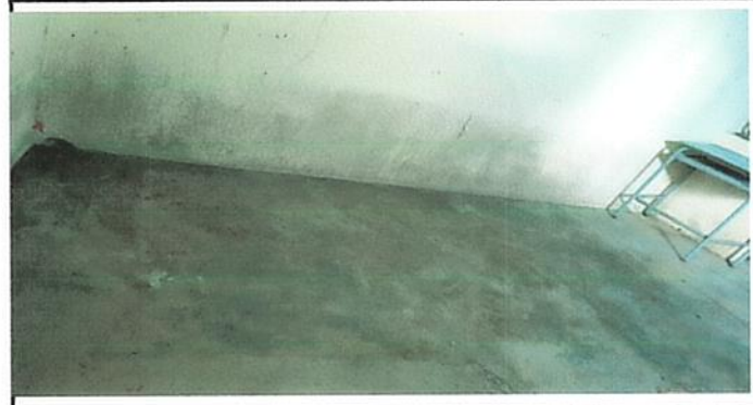
Foto 4: Humedad por retención de agua por goteras del techo.
