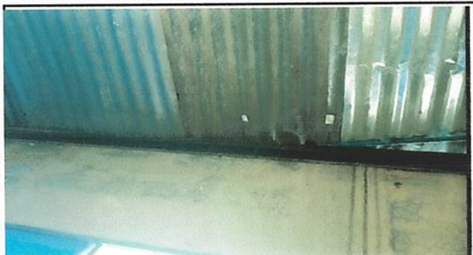
Foto 9: Láminas con goteras, sostenidas con palos, para que no se doblen con la lluvia. Paredes totalmente húmedas.
