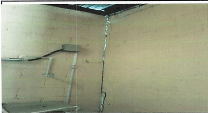
Foto 3: Lados diferentes en paredes diferentes gretadas por sismos.
