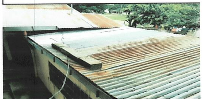
Foto 8: Se observa la lámina levantada que ya no resiste los clavos, se han colocado block, para que el aire no las levante.
