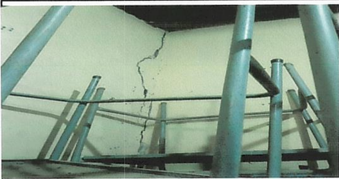
Foto 1: Paredes rajadas por sismos.
